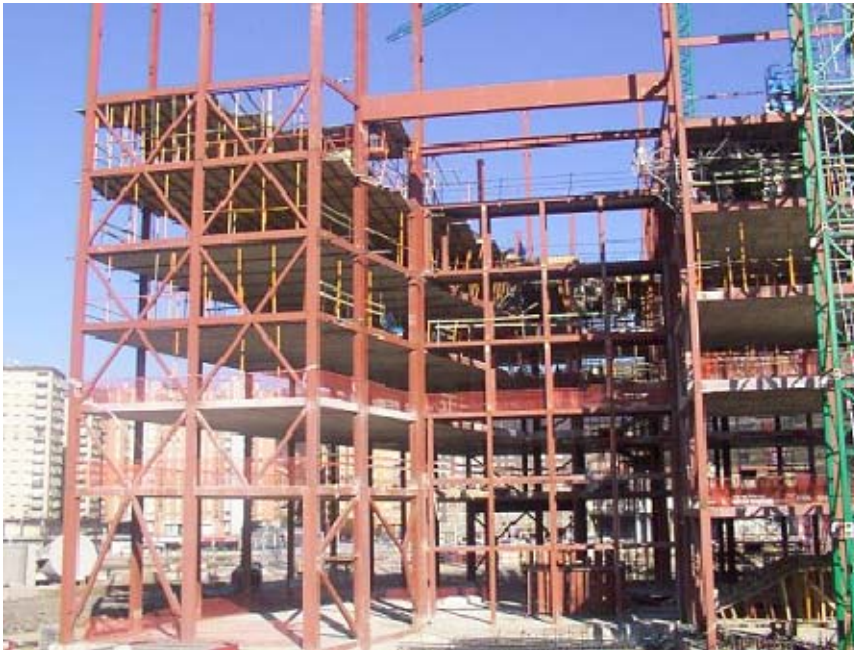
Figura 4.1 Vista que muestra la estructura de acero para el área del atrio y sistema de arriostramiento.
