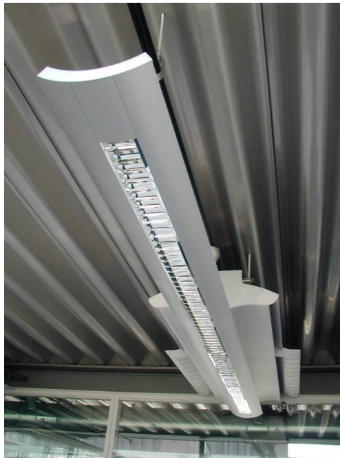
Figura 3.1 Chapas de acero inoxidable laminado e iluminación/ unidades de distribución de aire acondicionado
