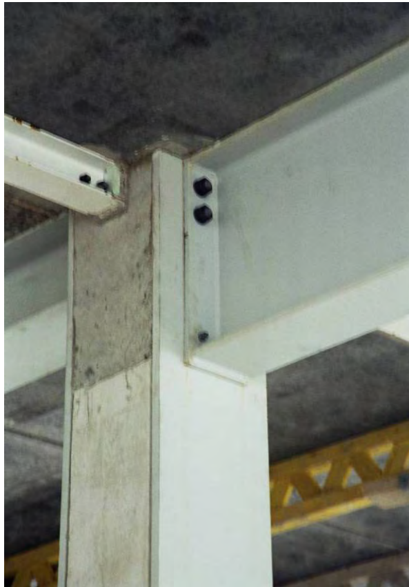
Figura 4.1 Detalle de la unión de una viga en un pilar parcialmente embebido
